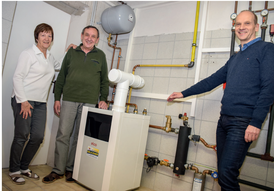
Das neue Herzstück in Sachen Wärme im Hause Teufl: die neue Gas-Brennwert-Anlage von Haustechnik Bruckner.
